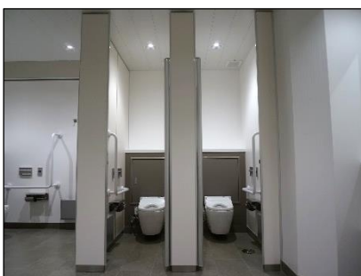
△便房(洋式トイレ)
